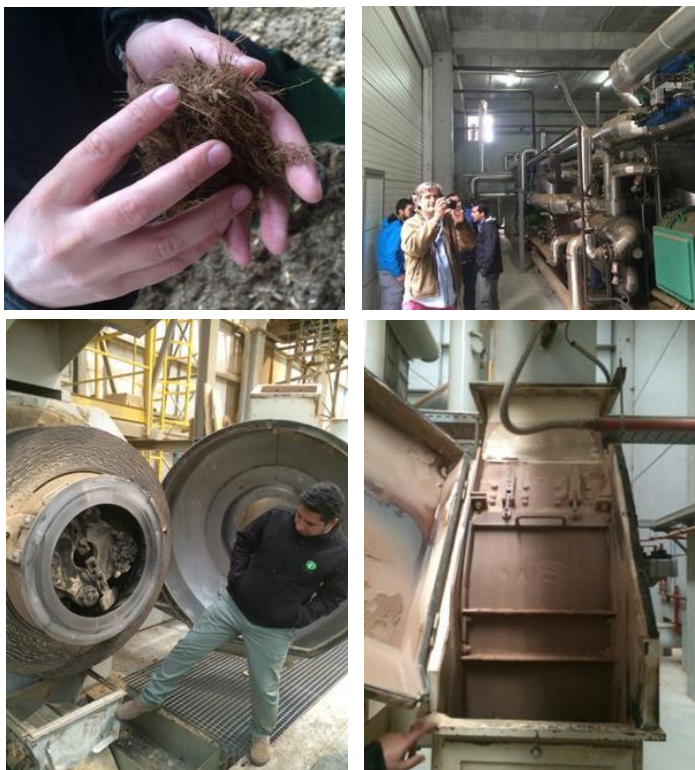
Figura N° 14 ASPECTOS DE LA PLANTA DE COGENERACIÓN DE GALPELLET
