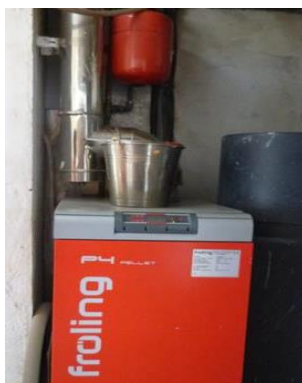
Figura N° 11 CALDERA DE PELLETT
